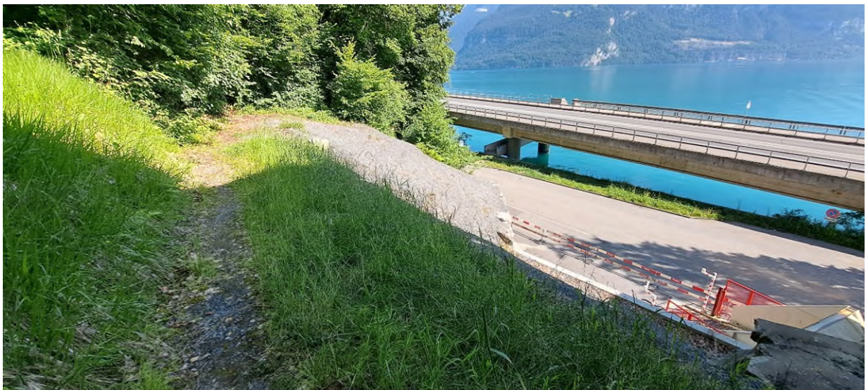
Abb. 12: Im nordwestlichsten Bereich der Parzelle, wo Gebäude bis auf die Grundmauern abgebrochen wurden, ist das Gelände abgetreppst und fusst auf einen asphaltierten Platz.
