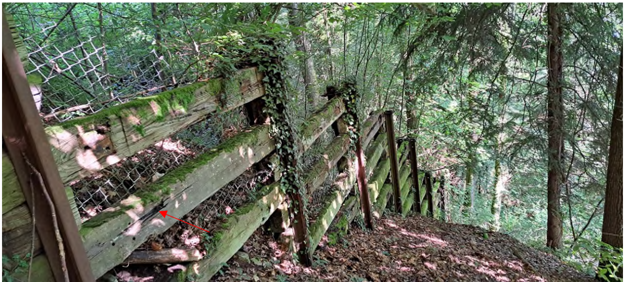
Abb. 6: Im Hang befinden sich zwei alte Palisaden. Sie bestehen aus H-Trägern mit einer Ausfachung aus Eisenbahnschwellen und eingelegtem Drahtgeflecht. Sie weisen eine Höhe von 1 – 2 m auf. Die Schwellen sind teilweise morsch (Pfeil).
